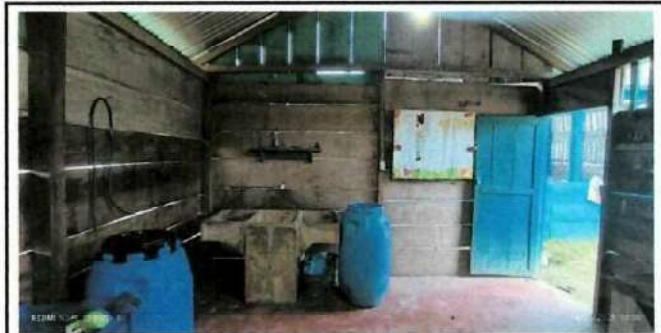
Foto 5: Se observa la cocina en mal estado
