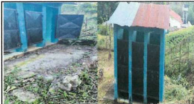
Foto 3: se observaba el piso y el techo de los baños en mal estado
