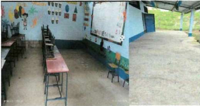
Foto1: se observa el piso rustico en 2 aulas y corredor
