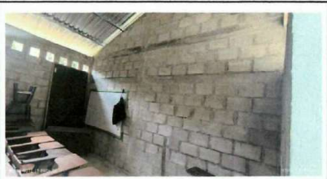
Foto 2: se obseva la falta de ventilación en 2 aulas
