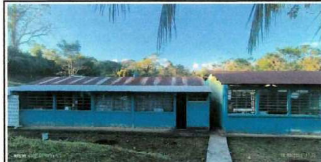
Foto 6: Se observa la pintura de las aulas en malas concidiones
