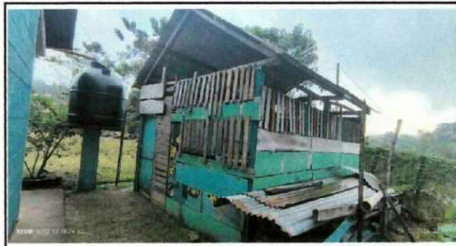
Foto 4: Se obseva el comedor en mal estado
